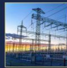
Concessionárias Distribuidoras de Energia
